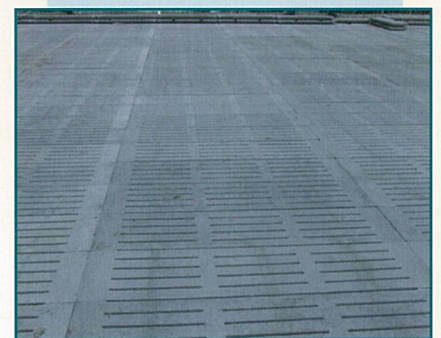
Sertés taposórács beépítés közben
